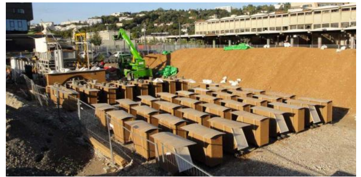
Aire de préfabrication des blocs pisé sur le chantier Ydeal Confluence. Fabrication Nicolas Meunier, entreprise « Le Pisé ». Crédit : Vergély architectes
